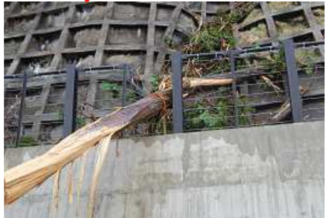
※暴風による倒木被害写真
