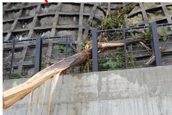
※暴風による倒木被害写真
