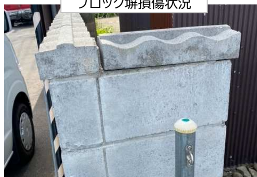
ブロック塀損傷状況
