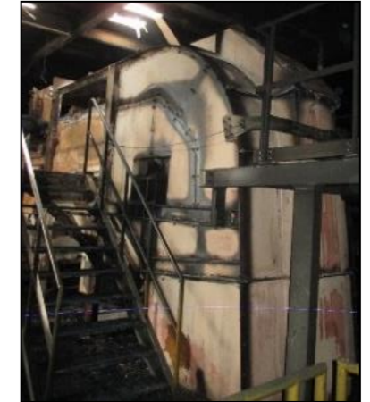
④破碎物コンベヤ（選別室6階側）
