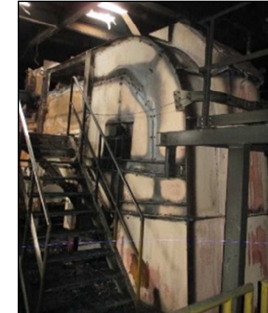
④破碎物コンベヤ（選別室6階側）
