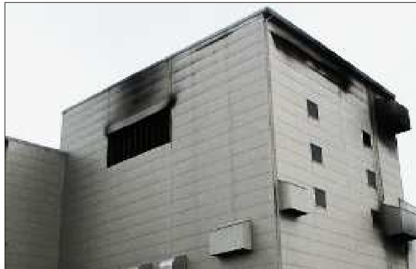
①破碎選別処理施設（外観）
