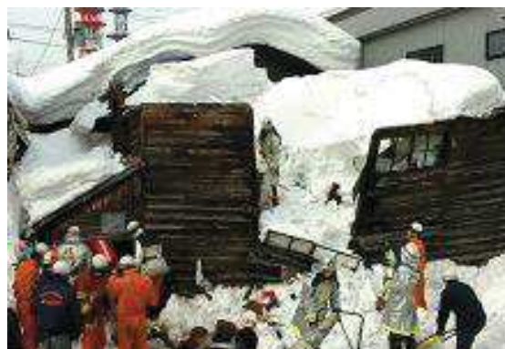
図 46 雪の重みで倒壊した家屋
