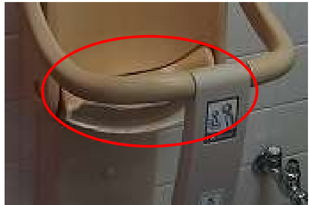
(座面破損状況)
