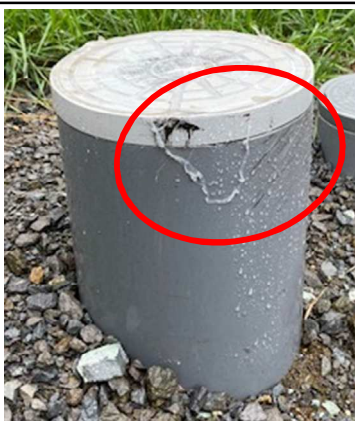
相手方柵のカバー損傷
