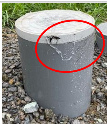
相手方排水柵損傷
