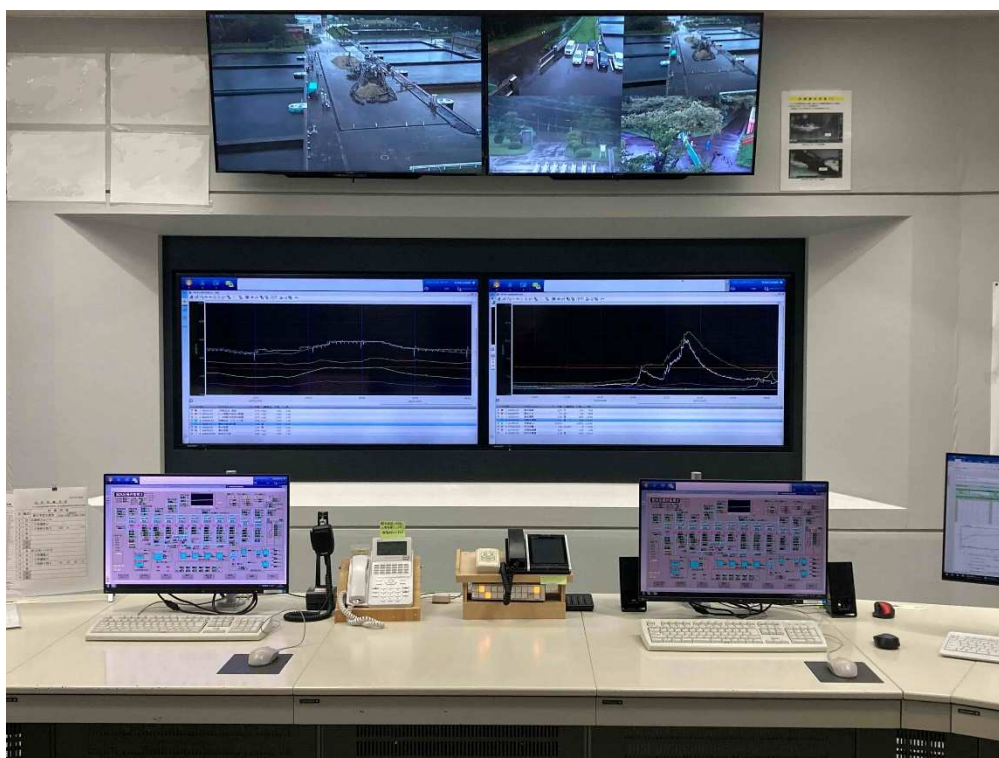
横内浄水場中央制御室
