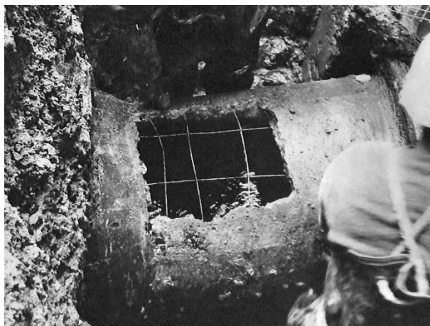
十勝沖地震 * による導水管 * の破損
