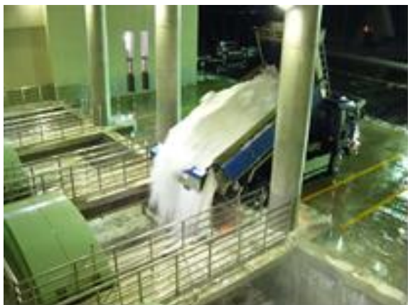
[八重田浄化センター内積雪・融雪処理槽]
