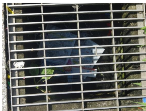
○水場の排水溝にごみが溜まっています。
