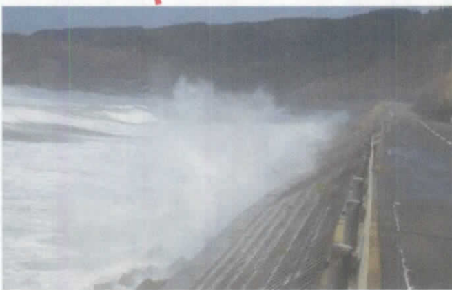
※高波による交通障害写真
