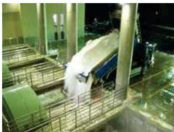
図 72 八重田浄化センター内 積雪・融雪処理槽
