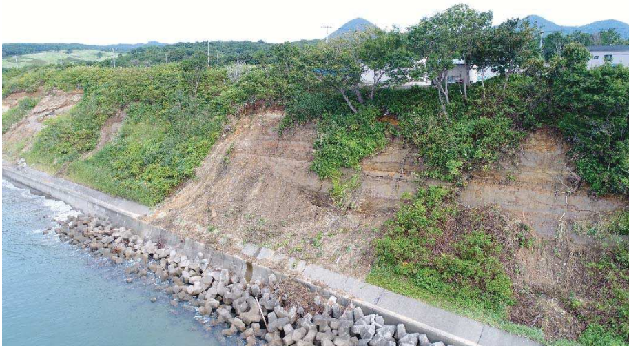
【法面崩落箇所】
