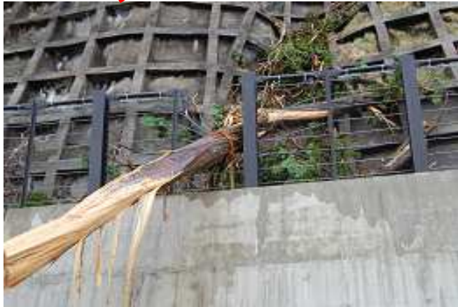
※暴風による倒木被害写真
