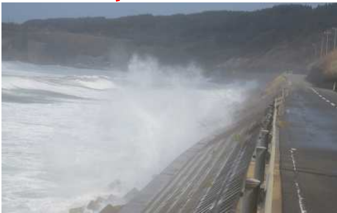
※高波による交通障害写真
