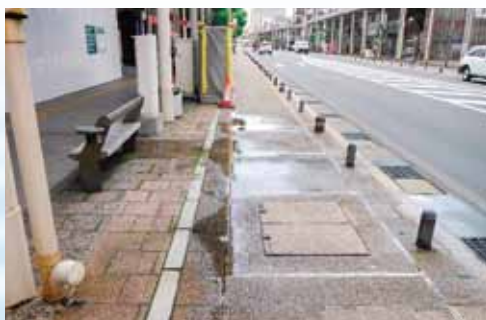
夏期漏水のイメージ写真
