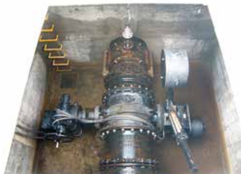
横内浄水場緊急遮断弁
