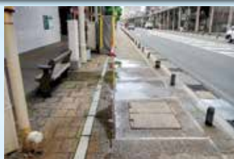
夏期漏水のイメージ写真
