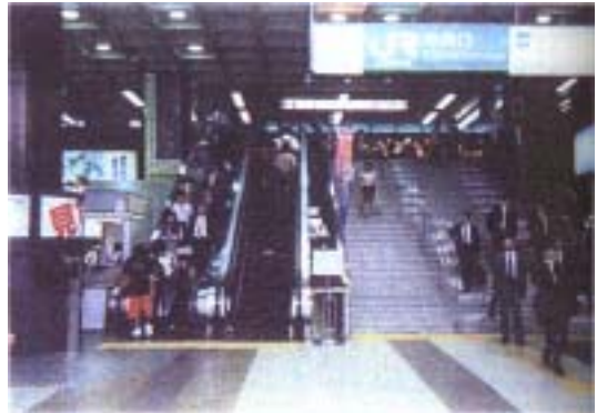
図 バリアフリー設備の例(エスカレーター)
