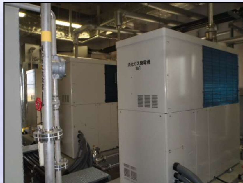
ガス発電設備(新田浄化センター)
