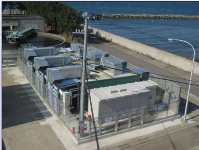
ガス発電設備(八重田浄化センター)
